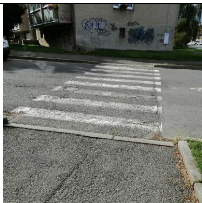
D69 Přechod pro chodce přes jižní rameno okružní křiž. Seifertova × S. K. Neumanna × Čechovská × K. Kryla
