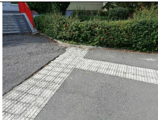
B60 Hmatové úpravy u přechodu pro chodce přes ul. Milínská, před hlavním vstupem do OC Skalka
