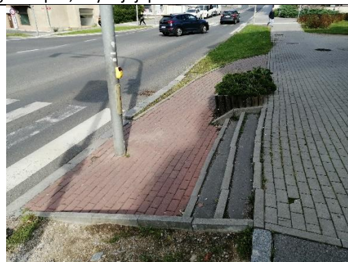
B62 Vyčkávací prostor u přechodu pro chodce přes ul. Milínská, před okresním soudem
