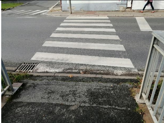
C33 Přechod pro chodce přes ul. Březnická v místě mostu pro pěší
