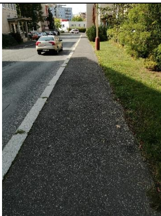
A7 Chodník na severní straně ul. U Nemocnice (k budově ZÚ)
