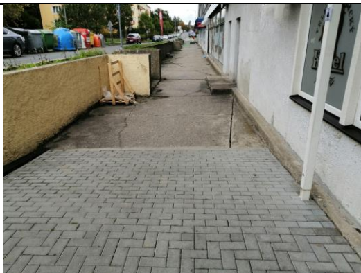
D21 Chodník kolem budovy velké haly zimního stadionu
