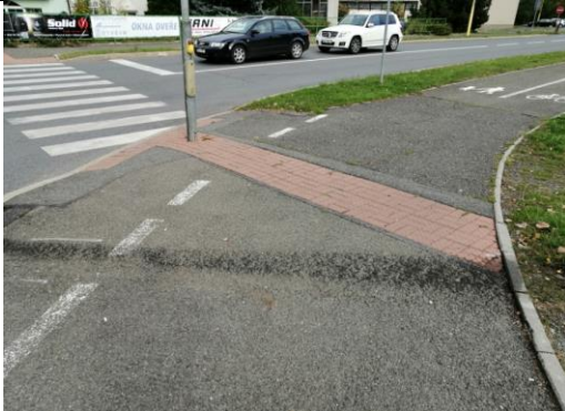
D75 Přechod pro chodce přes východní rameno křiž. K. Kryla a Žežická BARIÉROVÝ
