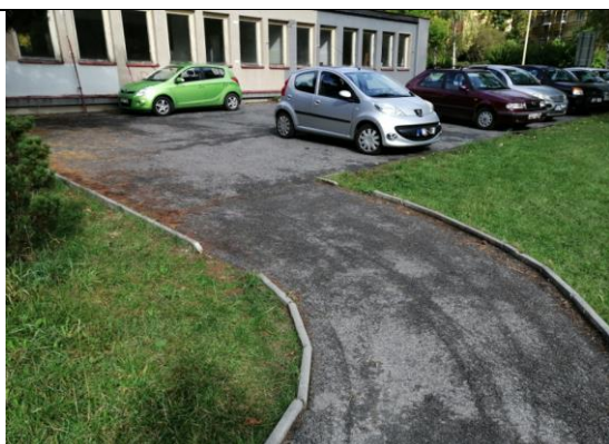
C92 Chodník k parkovišti u Centra nezisk. organizací a přístup k chodníku na ul. Žežická
