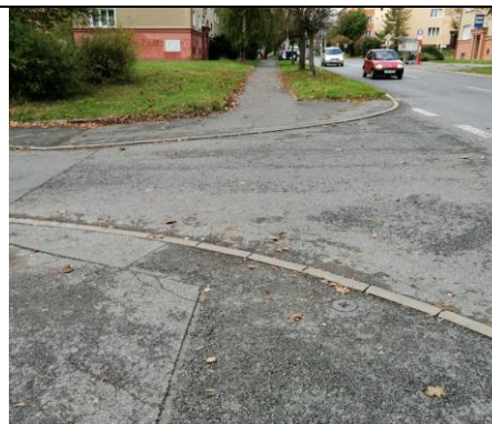
C79 Převedení chodců přes ul. Ostravská u křiž. s ul. Politických věžňů BARIÉROVÉ
