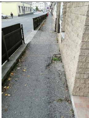
C17 Chodník v ul. Čs. armády před budovou č. p. 12 a 145
