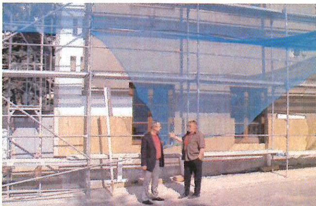
Další rozsáhlou investiční akci, kterou místostarosta MUDr. Ivan Šedivý pravidelně kontroluje, je zateplení budovy Základní školy Březové Hory. Součástí této stavby je i výměna oken.
