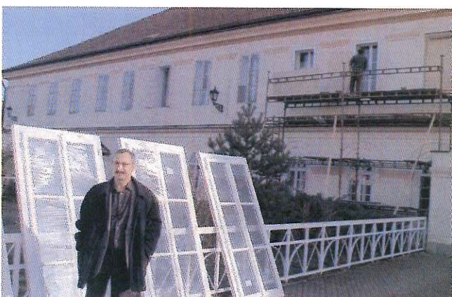
Ředitel Pečovatelské služby Příbram a 1. místostarosta MUDr. Ivan Šedivý kontroluje postup prací při výměně oken na budově Domu s pečovatelskou službou na Březových Horách.
