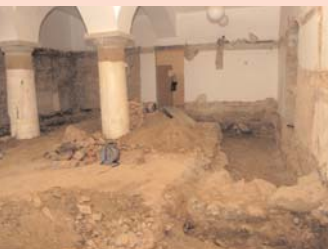
V historickém domě rodiny Holých na náměstí T. G. Masaryka byly při rekonstrukci odkryty základy budovy.
