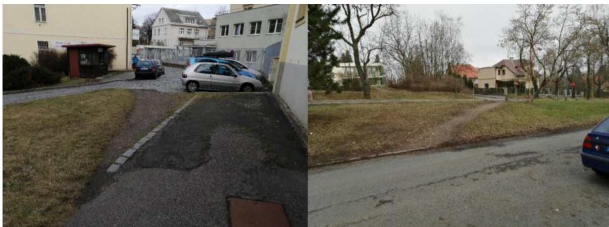
Obrázek 45 Chybějící pěší návaznosti a části chodníků - ul. Hradební, Mariánská
