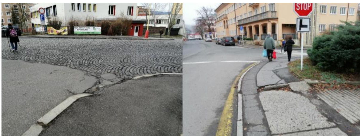
Obrázek 41 Nestandardně snížená obruba, špatný stav povrchů chodníků - ul. U Nemocnice, Gen. R.Tesaříka
