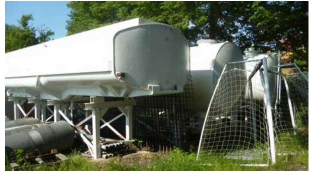
nádrže na užitkovou vodu
