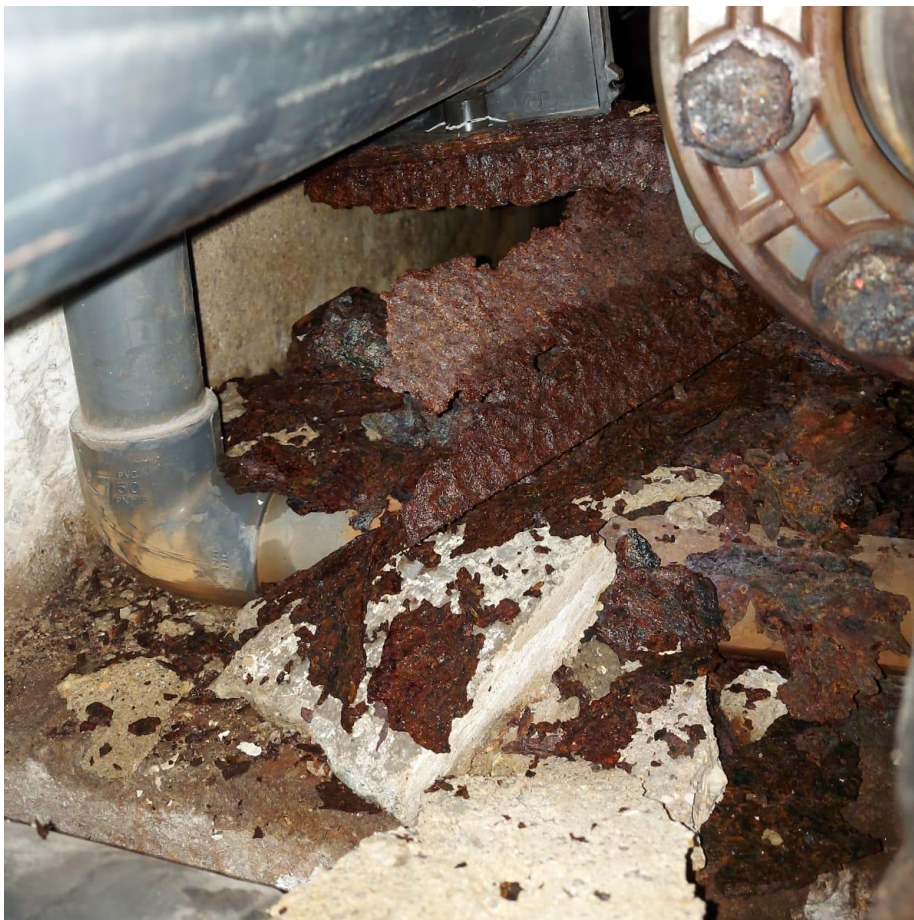
Obrázek č. 2.4 Havarijní stav nosníků
