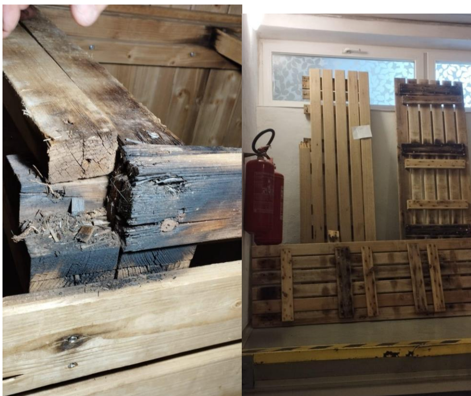
Fotografie č. 11 Ztrouchnivělá konstrukce potírny sauny
