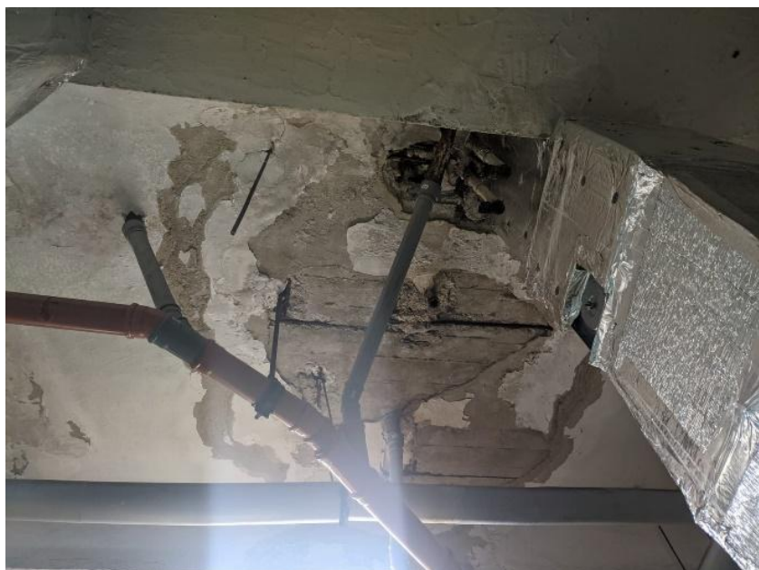
Fotografie č. 8 Prasklé odpadní potrubí pánské sprchy
