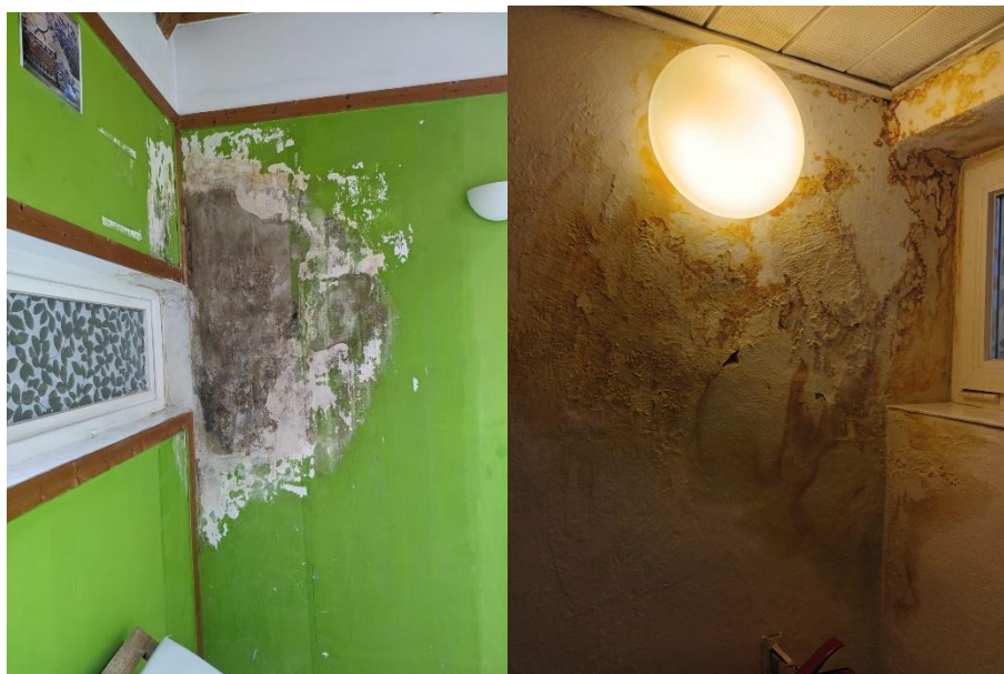
Fotografie č. 9 Zatékání střechou do sauny
