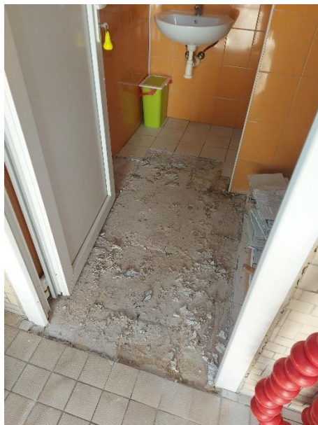
Fotografie č. 10 Odlepení podlahy WC malý bazén
