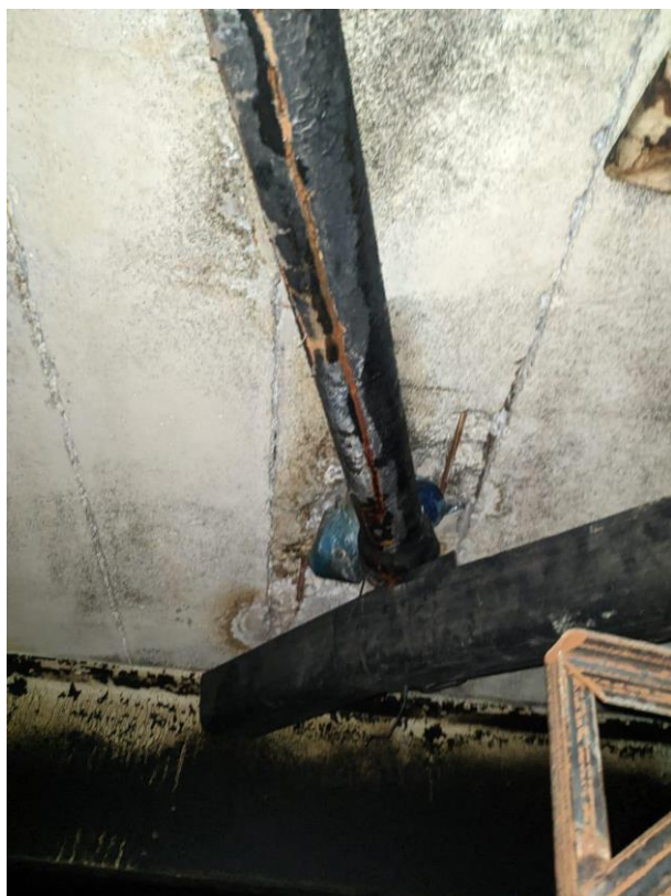
Fotografie č. 14 Prasklé odpadní potrubí sauny
